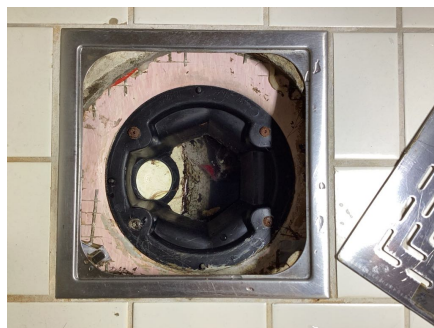
Synlig varmekabel i sluk.
