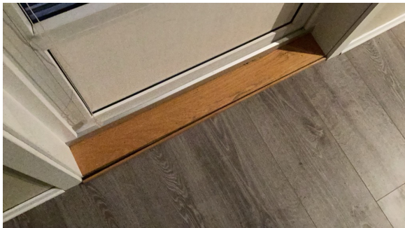
Løs feielist ved balkongdør
