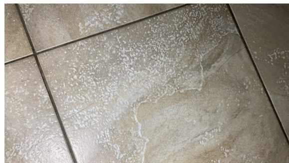
Stedvis små sprekker i flisgulv på kjøkken.
