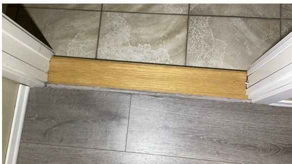
ufagmessig fug mellom laminat og dørterskler.
