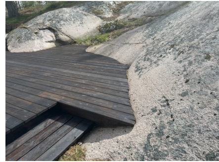
Råte i enden på terrassebord.
