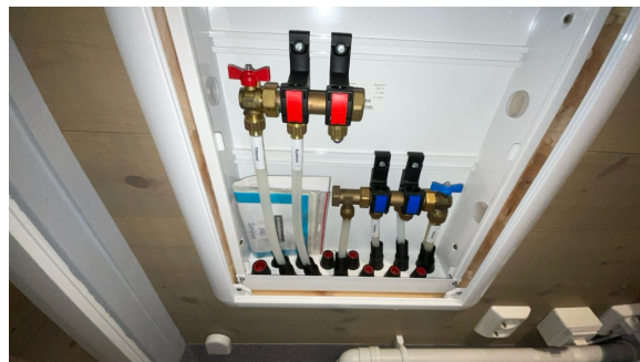
Vannforderskap i bod første etasje.
