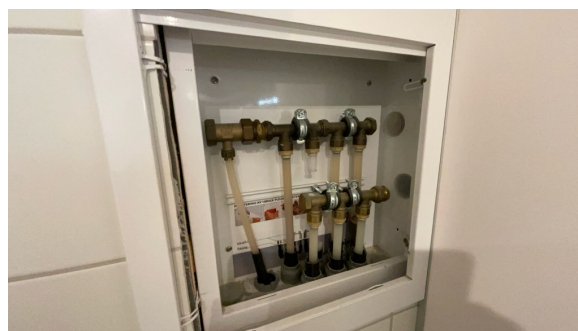
Vannforderskap i badet i første etasje. Kurser er ikke merket, og det er ingen synlig/tilfredstillende drenering i bunnen av fordelerskapet.
