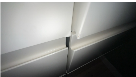
Fukt svelleskade fronter ved oppvaskmaskin.
