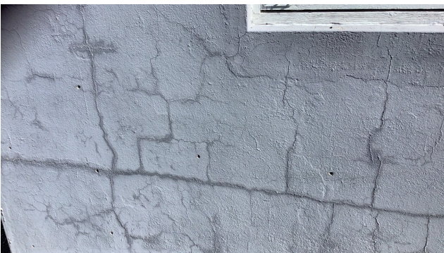
Mindre sprekker/riss i muren utvendig
