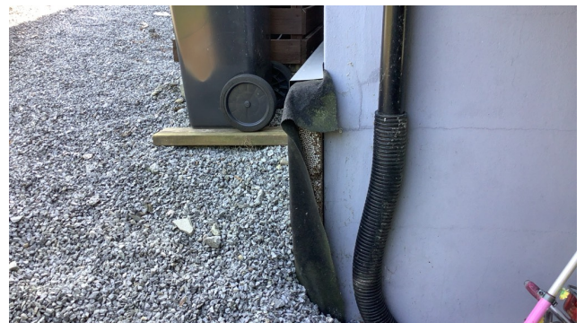
Drensløsning som ikke er tilfredsstillende avsluttet på hushjørne.
