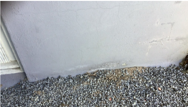
Avskaling av maling på mur.
