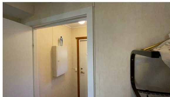
Manglende klamring av kabel.
