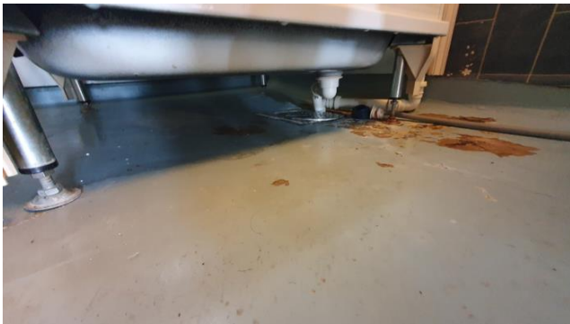
Under dusjkabinett, med avløp til sluk
