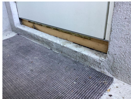
Manglende beslag under dør.
