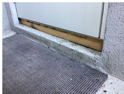
Manglende beslag under dør.
