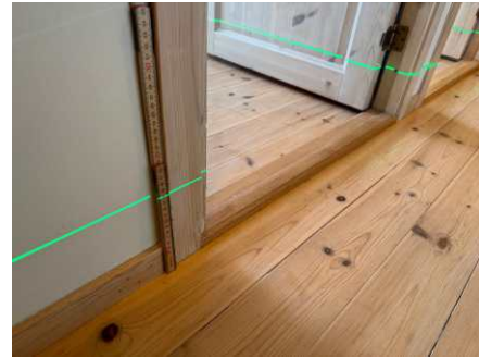
Lokale skjevheter i 2. etasje
