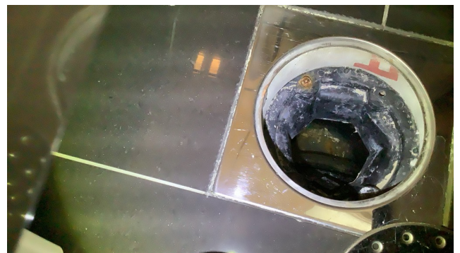
Sluk ved baderomsinnredning.
