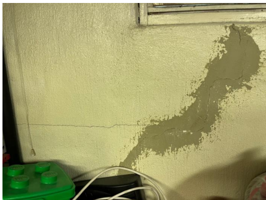
Viser sprekker i mur.
