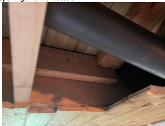
Viser åpent i gulv under bad.
