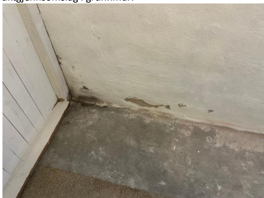
Viser fuktgjennomslag i grunnmur.
