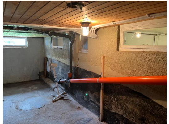
Viser deler av avløpsrør.
