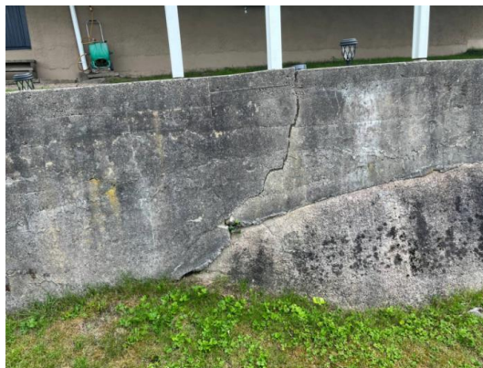
Viser støttemur med sprekker/setninger.
