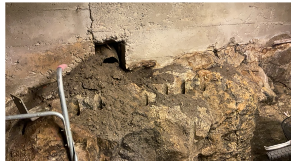
Det er påvist synlig fuktighet i kjeller.
