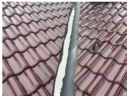
Dels påvist avflassing av plastbelegg på beslag.
