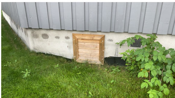
Inngang til krypkjeller var fysisk avstengt på befaring
