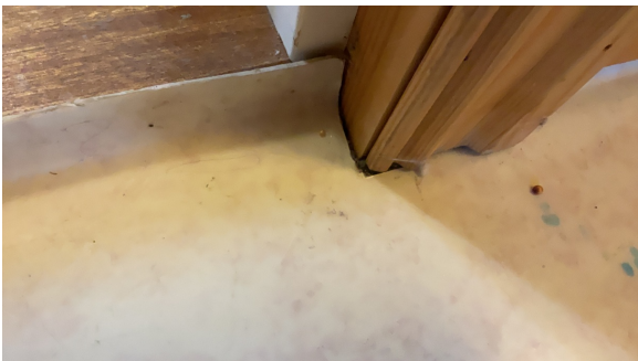
Belegg er ikke tett i overganger
