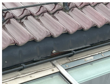
Dels påvist avflassing av plastbelegg på beslag.
