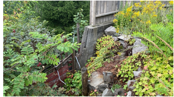
Armeringsjern stikker ut ved avslutningen av forstøtningsmur.
