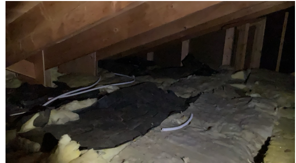
Det er begrenset/dårlig ventilering i deler av takkonstruksjonen.
