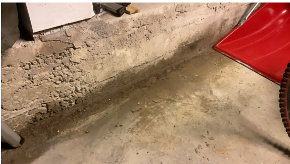
Det er påvist synlig fuktighet på mur/gulv i kjeller.
