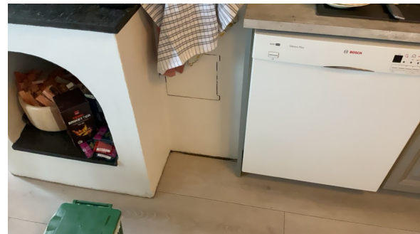
Ildfast plate mangler på gulvet under sotluke/feieluke på pipe i kjøkkenet.
