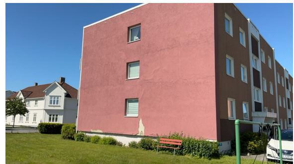
Gavlvegg har skader.
