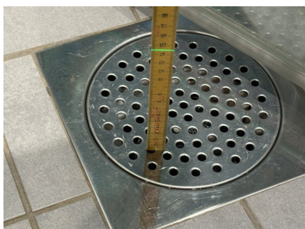
Fallforhold ca. 145 mm topp slukrist i dusjsone
