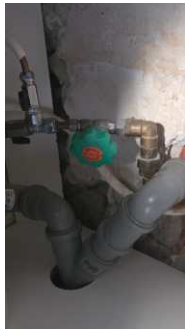
Vann- og avløpsrør i kjøkkenbenk, m/stengeventil.
