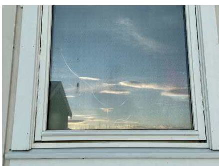
Vindu med sprukket glass.
