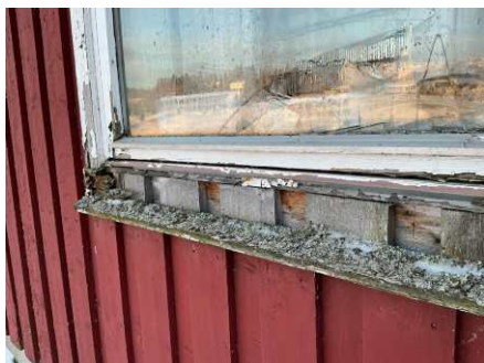
Eldre vinduer er slitt og har behov for utskifting.
