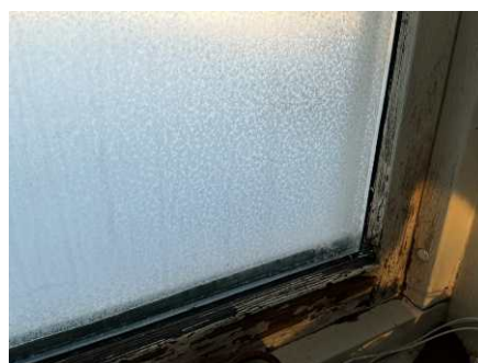
Flere vinduskarmen har fuktskader innvendig.
