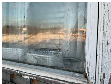
Flere vinduer i boligen har knust glass.
