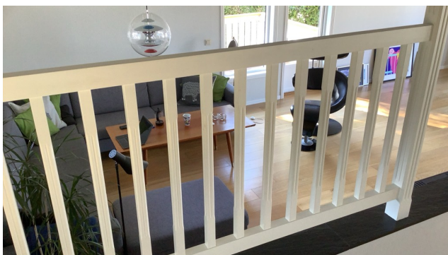
Åpninger i rekkverk på over 10 cm.
