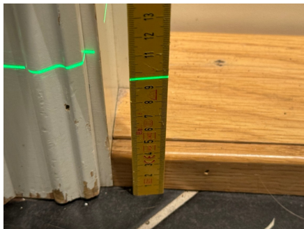
Fallforhold ca. 95 mm overkant gulv ved terskel
