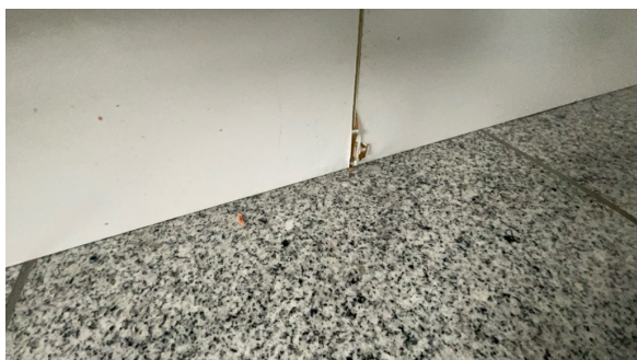
Skade i sokkel
