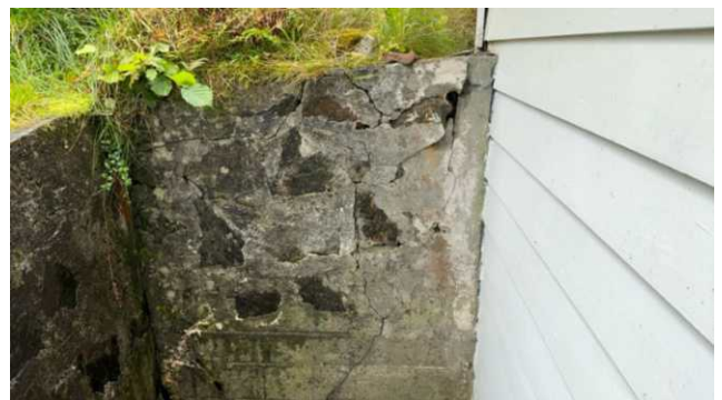
Riss i mur
