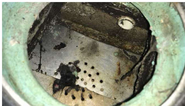
Bildet viser dyptliggende sluk.
