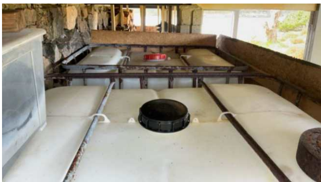
Vanntanker til tak vann
