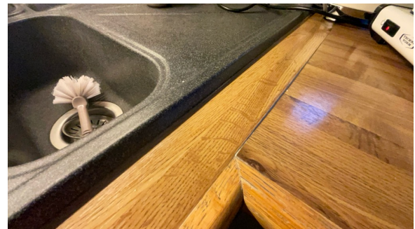
Benkeplaten har noe fuktsvelling i skjøten.
