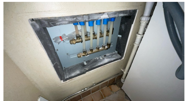
Vannfordelerskap plassert i vaskeromsdelen.
