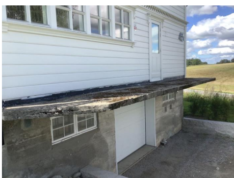
Ikke i bruk. Dør tettet fra innsiden
