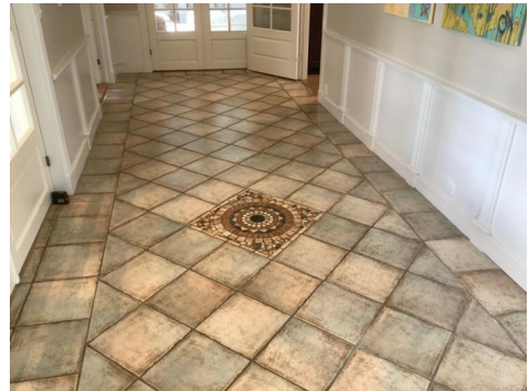
Målt skjevheter i hall
