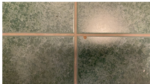
Flis med avskalling.
