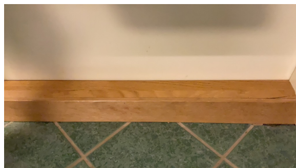
Våtrommet mangler tilluftsventilering, f.eks. spalte ved dør.
