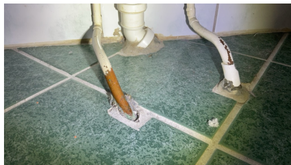
Utilfredstillende tetting ved rørgjennomganger
