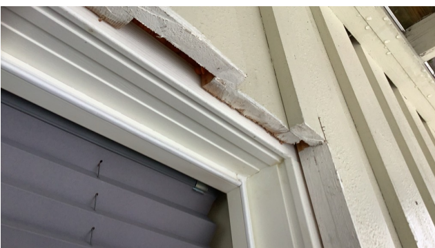
Det er ikke tilfredsstillende tetting over døren.
