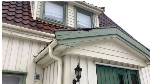
Råte i vindskier.
