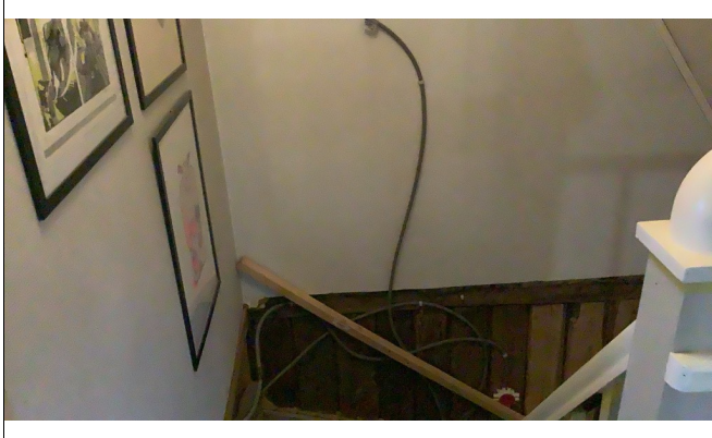
Åpne el-ledninger på vegg i trapp.
