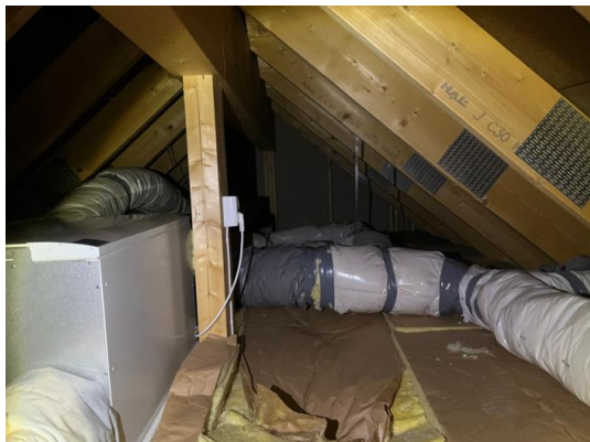
Viser ventilasjonsanlegget på loftet.
