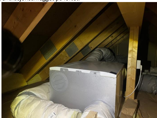
Viser ventilasjonsanlegget på loftet.
