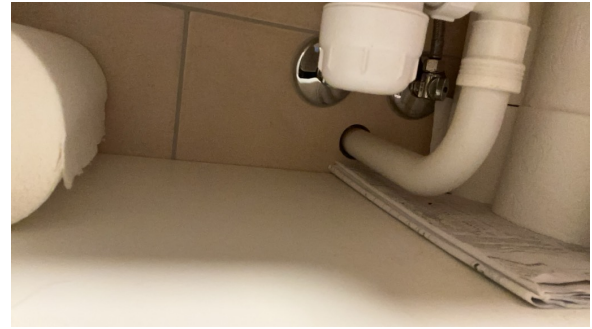
Utett gjennomføring rund avløpsrør
