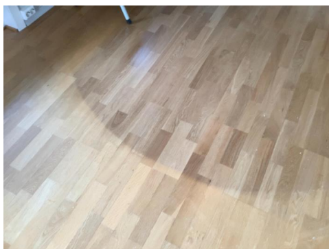
Det er skjolder i parketten.
