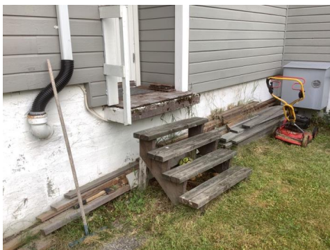
Trapp mangler rekkverk.
