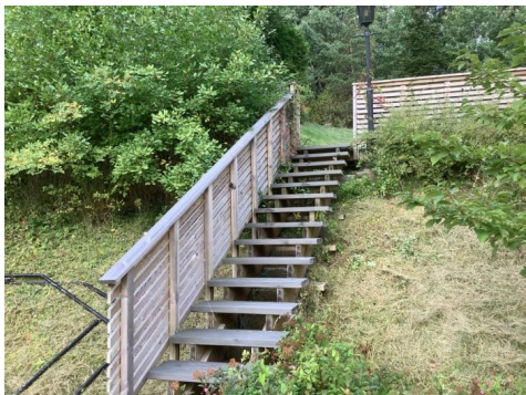
Trapp mangler rekkverk.
