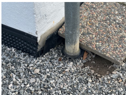
Det er åpning/glippe mellom klemlist og grunnmursplast nordøst side.
