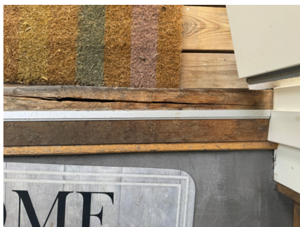
Hovedytterdør: Sprukket terskel
