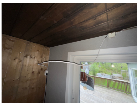
Kabler er ikke tilstrekkelig festet
