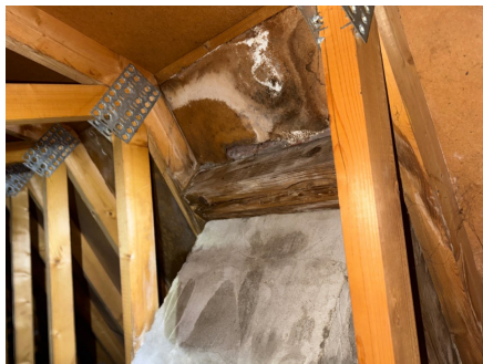
Påvist fuktskjolder, soppdannelse og skade på undertaksplater og treverk ved pipeutveksling.
