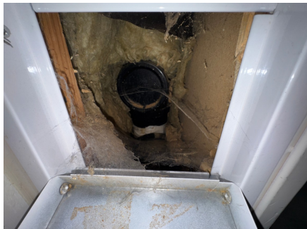
Inspeksjonsluke med stakepunkt
