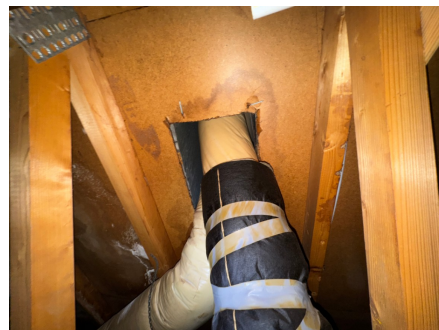
Påvist fuktskjolder og skade på undertaksplater ved rørgjennomføring av ventilasjonsrør.
