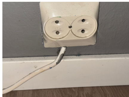
Kabler er ikke tilstrekkelig festet
