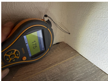
Fuksøk nedkant kjellervegg i bod i u.etg
