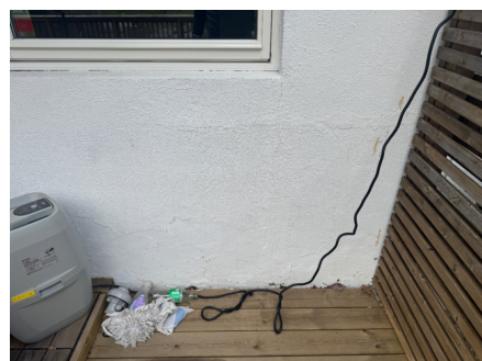
Sprekker i murte/pussede fasader
