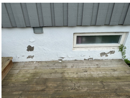
Løs puss på muroverflater
