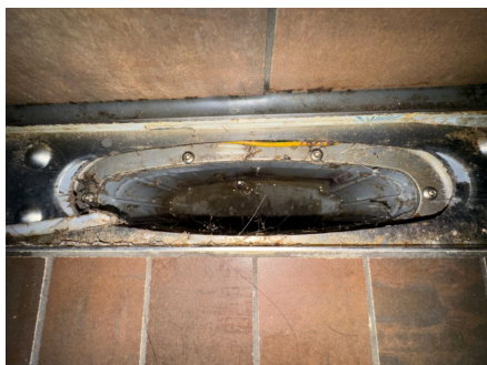
Slukrenne ved vegg i dusjeon. ynlig membran/mansjett
