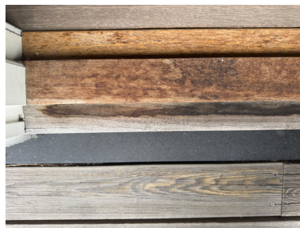
Balkongdør: Tersekelen har misfarging/fuktmerker
