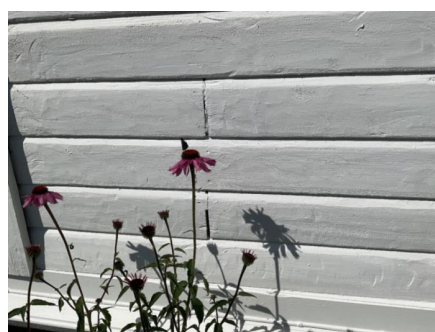
Sprekker i endeskjøter.
