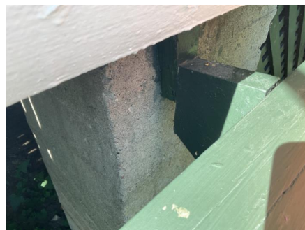
Innfesting av trapp har sklidd ned.
