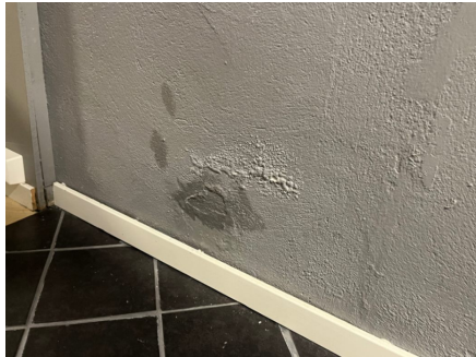
Saltutslag på vegg i rom under terreng.
