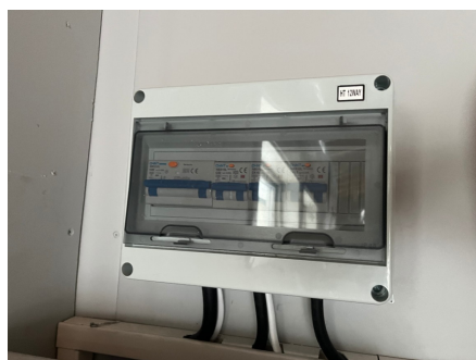
Sikringsskapet i dobbelgarasjen.
