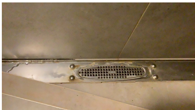
Riss i fuger ved sluket.
