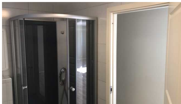
Bildet viser dør i våtsone.
