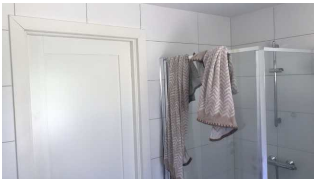
Bildet viser dør i våtsonen.
