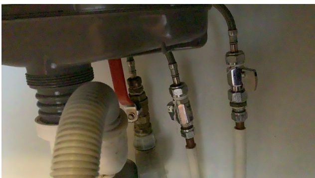
Stoppekran i benkeskapet.
