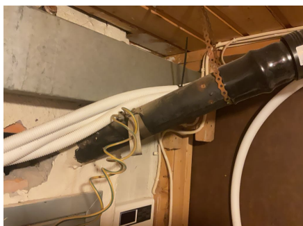
Støpejernsrør i grunn og plast rør i bolig.
