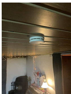
Det er montert røykvarslere i hver etasje.
