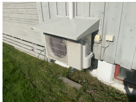
Varmepumpe utvendig del.
