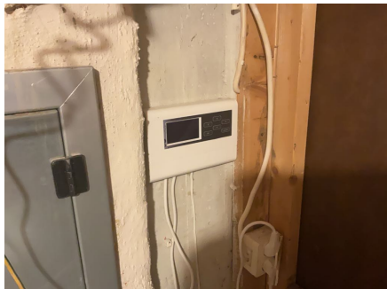
Det er montert vannstoppsystem ved varmvannsbereder i kjeller.
