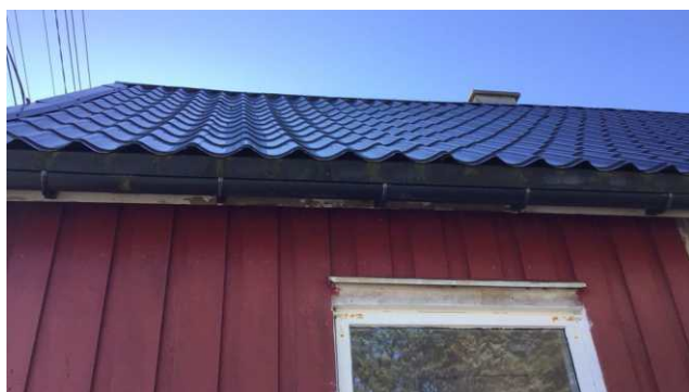
Nedbøyning mellom møne og takrenne.
