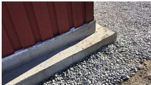
Det finnes ingen lufting av kledning i nedre kant.
