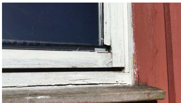
Råteskade i nedre hjørne, mangler klemlist i nedre kant av vindu.
