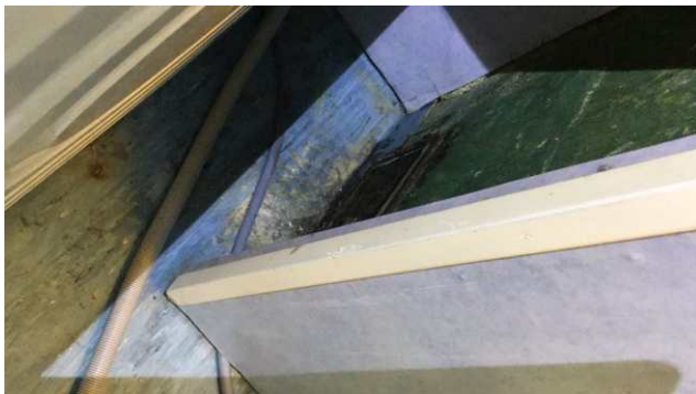
Det mangler ubrennbar plate under feieluke, det er også for kort avstand mellom feieluke brennbare materialer.
