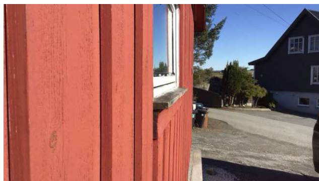
Vannbrett har for liten helning, slik av nedbør kan renne feil vei.
