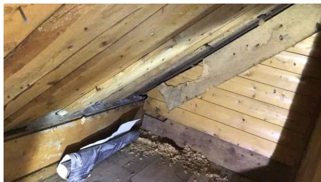
Tegn til at det har vært skadedyr og en ser tegn til vannlekkasje fra pipe.
