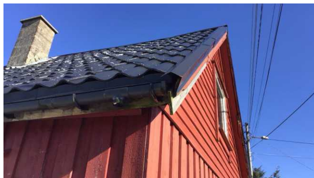
Mangler nedløp og avvik på beslag løsning i forbindelse med takteking.
