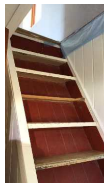
Trapp mangler 1 trinn. Det mangler rekkverk og håndrekke
