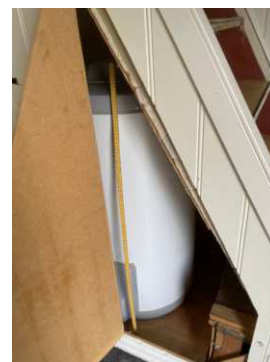
Åpning til varmtvannstank under trapp
