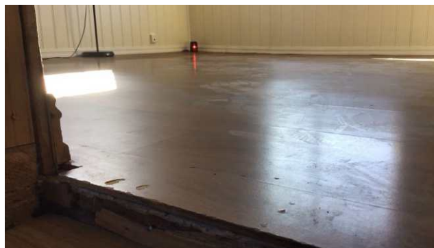
Stue gulv har ca 45mm skeivhet gjennom rommet.
