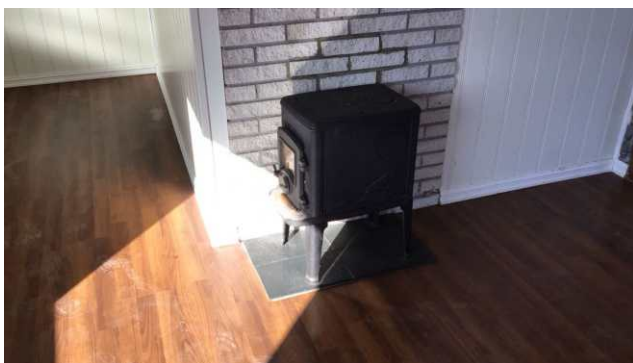
Ildsted står for nær brennbart, det mangler også tilstrekkelig ubrennbar plate under ovn.
