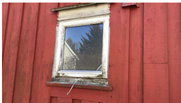
Værslitt, trenger vedlikehold.
