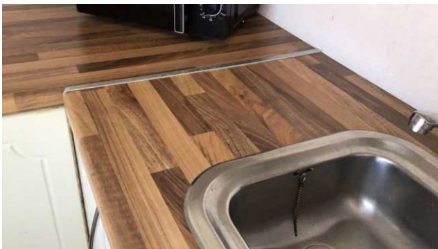
Svelling i benkeplate ved skjøt.
