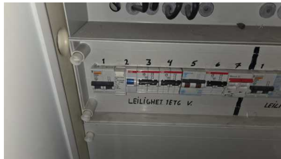
Automatsikringer er montert.
