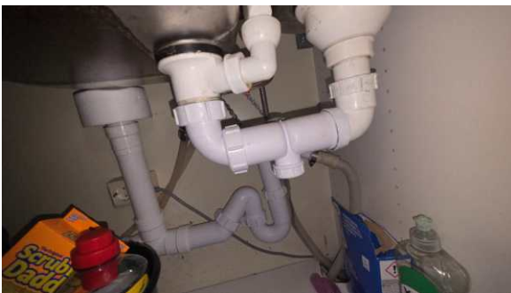
Avløpsrør i kjøkkenbenk
