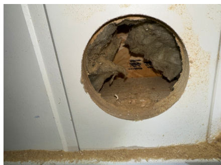
Hulltaking i tilstøtende soverom
