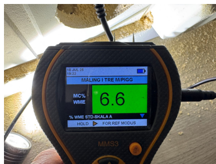
Hulltaking i tilstøtende soverom
