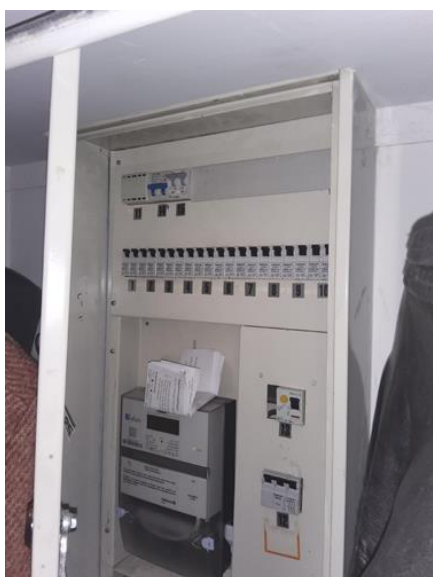
Elektrisk anlegg - [Sikringsskap]
