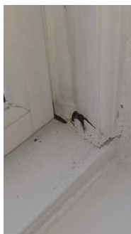
Råteskade i vinduskarm. Innmeldt skade til sameiet.
