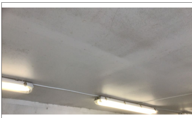
Det er fuktmerker innvendig i garasjen på tak og vegger.
