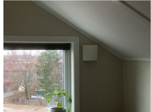
Veggventil i stuen.
