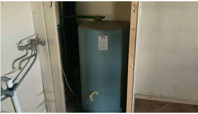
Varmtvannsbereder i uetg.
